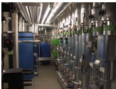
Technikzentrale ZENIT II
